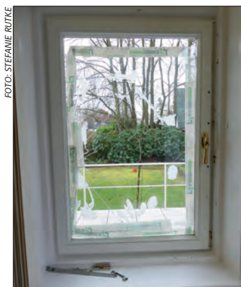
Die Scheibe zum Rathausbüro wurde eingeschlagen und eine Terrassentür gewaltsam aufgehebelt.
