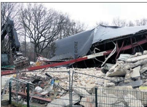
Nach wenigen Tagen liegt die Halle in Trümmern.
